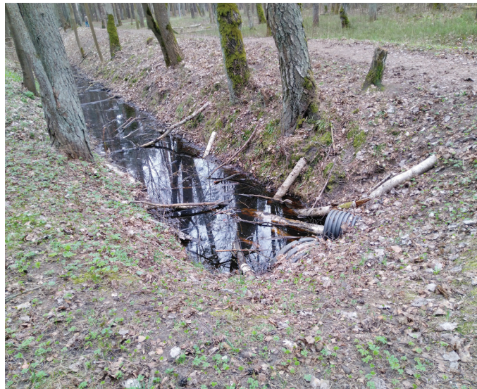
Grāvja G1 caurtekas, kas nefunkcionē
