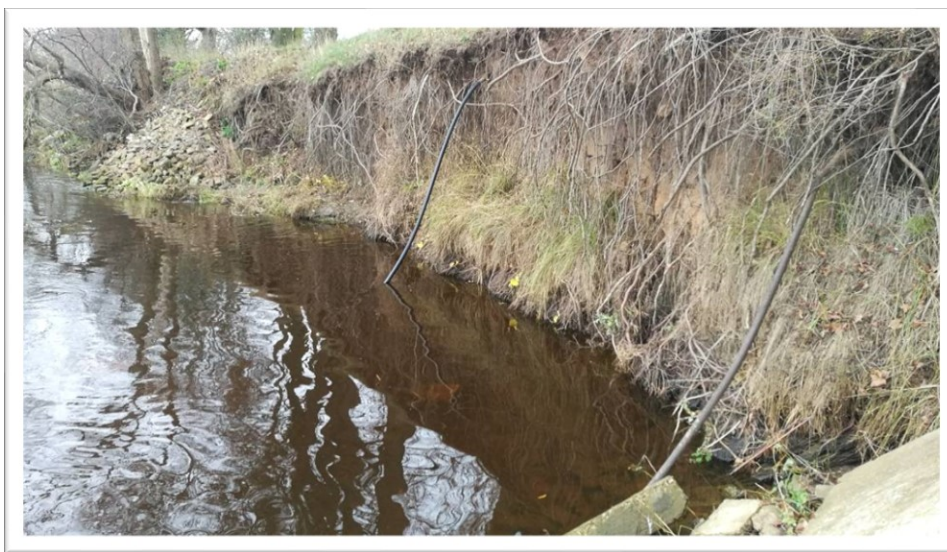
2. Attēls. 1. pastiprinātas krasta erozijas posms.
