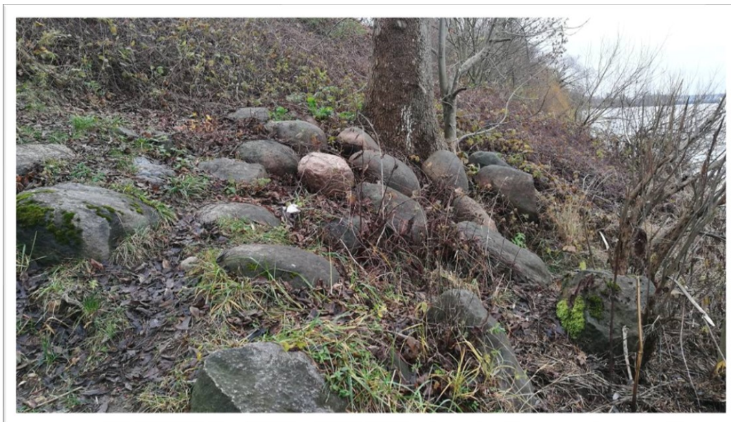
7. Attēls. 20. g.s. ierīkottu krasta stiprinājumu (laukakmeņu bankete) fragments pie Jāņogu ielas 48. Merenais nogāzes slīpums, laukakmeņu uzbēruma klātbūtne, lielie koki un dolomīta slāņu atsegumi nogāzē liecina par kādreiz notikušas erozijas pilnīgu apņemšanu.
